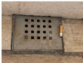
Evacuation d'eau au sol avec des « trous » taille mégot
